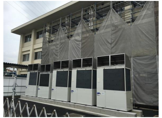
北舎の室外機
