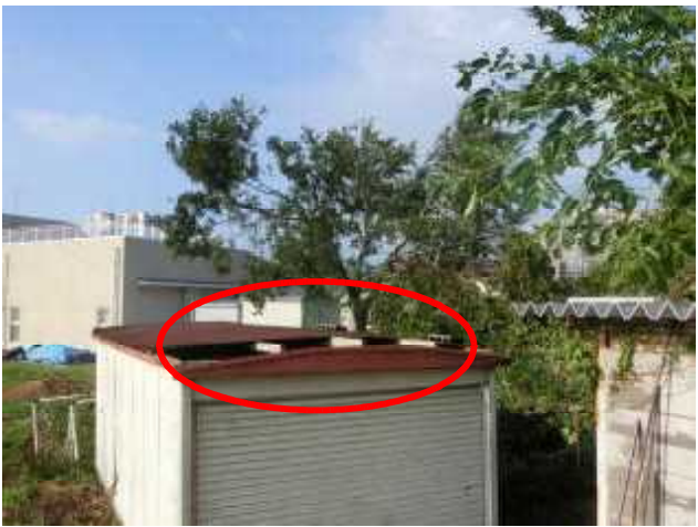
小中グラウンド 体育倉庫 屋根破損
