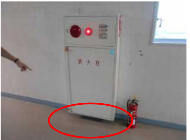
4階1 A前雨漏り
