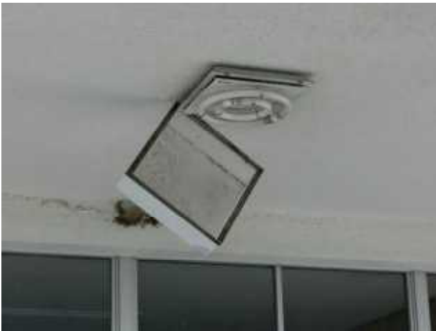
玄関 電灯カバー 破損
