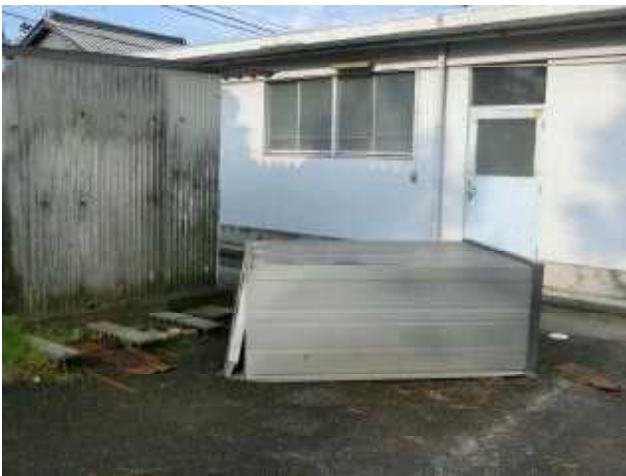
プール機械室東 スチールロッカー転倒
