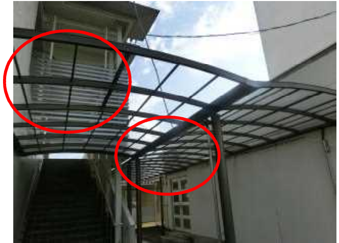
体育館への通路屋根アクリル板はがれ8枚
